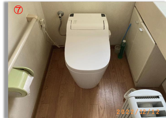
■トイレ■ トイレ便器用手すり
