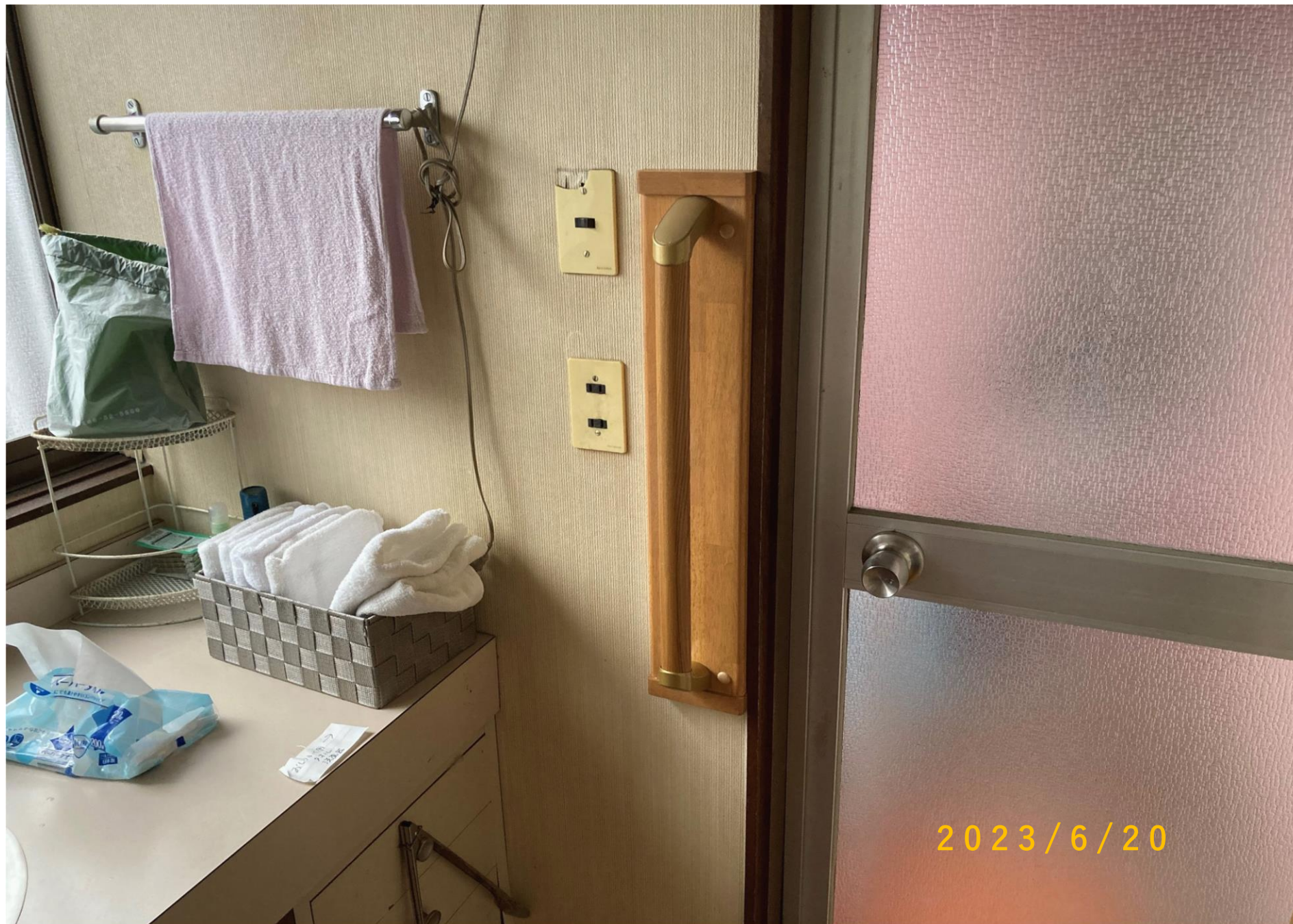
完成写真④ 洗面脱衣室 手すり
