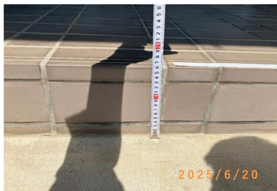
■ 段差確認 ① ■
